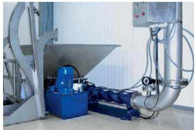
Pompe de la série BT 35-12 en amont du dispositif de levage de conteneur
